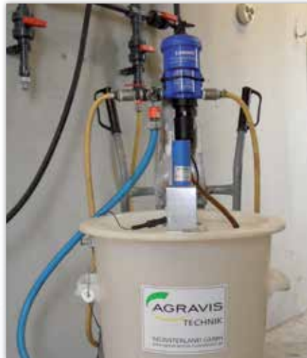
Pumpentechnik inkl. Additivbehälter für die Dosierung von Additiven (z.B. Ergänzungsfuttermittel, Arzneimittel) und Trinkwasserdesinfektionsmitteln
