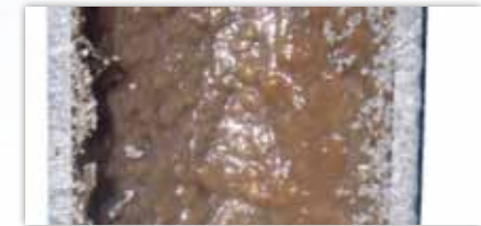
Ablagerungen können durch konsequente Hygienemaßnahmen in Wasserleitungssystemen verhindert werden.
