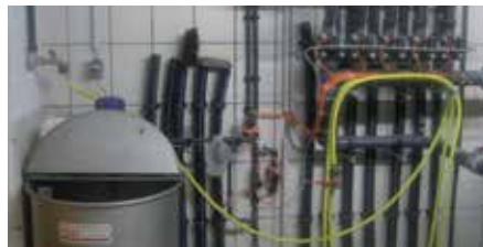
Stichleitungssystem inklusive Additivbehälter
