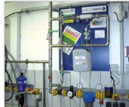
Einsatz von Chlordioxid über eine Dosiereinrichtung
