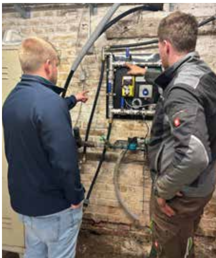
Johannes Schmitz (li.) erläutert dem Landwirt die Chlordioxidanlage.
